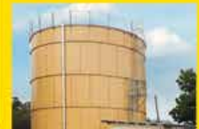
Tanques de Almacenamiento de Aguas
