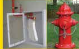
Hidrantes Externos e Internos
