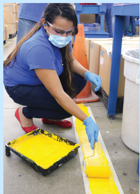
La buena señalización contribuye con el orden y la seguridad.
